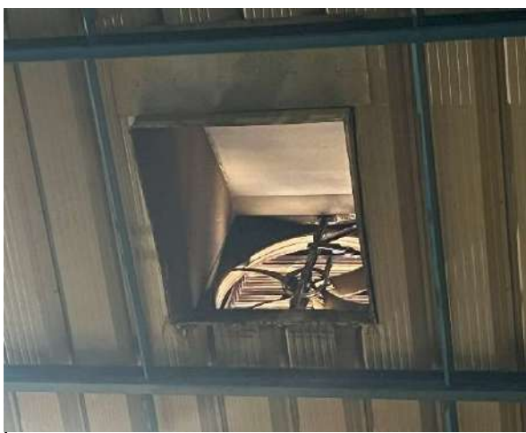
Bolos: Exaustor Rotoplast
