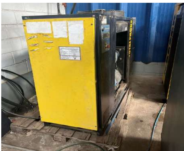
Utilidades: Compressor de Ar Parafuso
