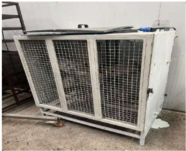
Tortilhas: Ventilador 3CV Resfriamento
