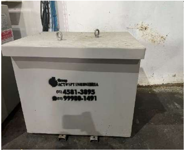
Snacks: Transformador 100KVA
