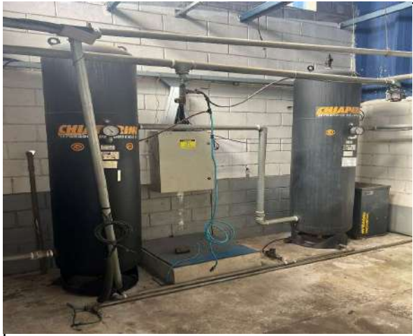
Utilidades: Tanque Pulmão Ar Comprimido
