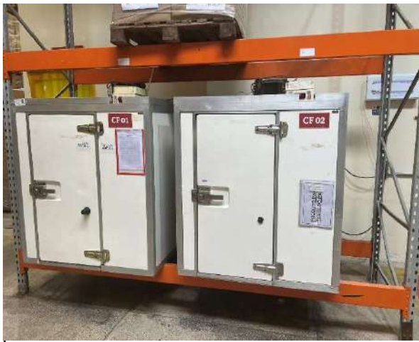
Almoxarifado: Câmera Frigorífica 1,2x1,8m
