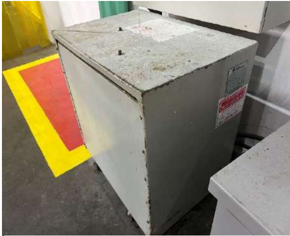
Snacks: Transformador 75KVA
